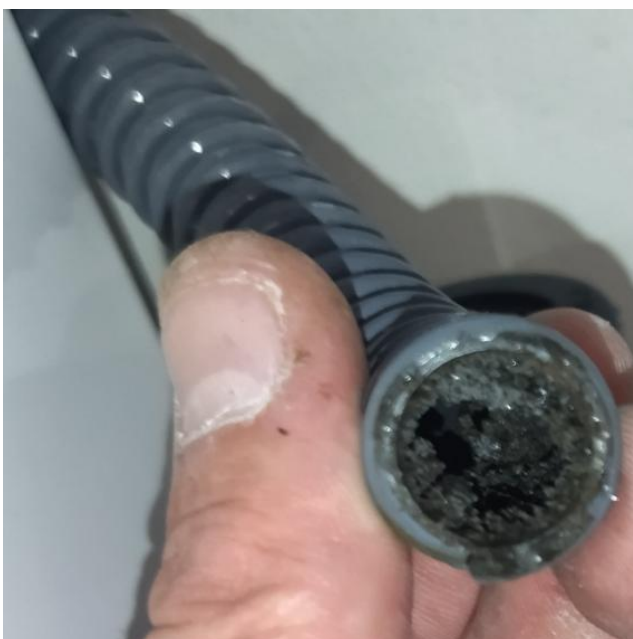
Obrázek 6 - Ucpaný odvod kondenzátu
