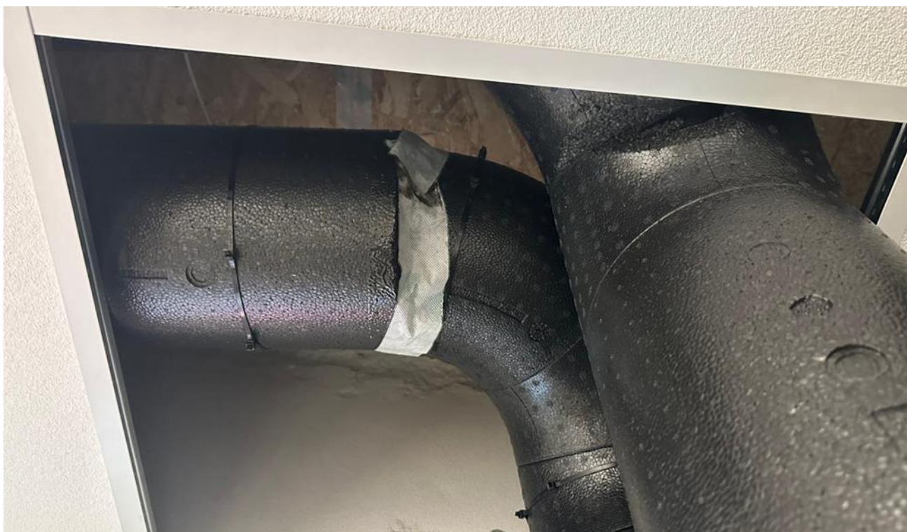
Obrázek 7 - Netěsnosti v přívodním EPP potrubí
